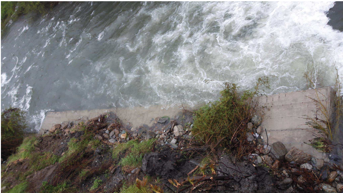
Foto 2: Muro esistente in c.a. di arginatura e protezione del pendio completamente ribaltato in alveo.
