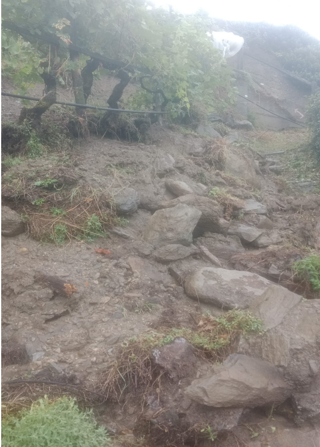
Foto 1 dissesto con crollo del muro
